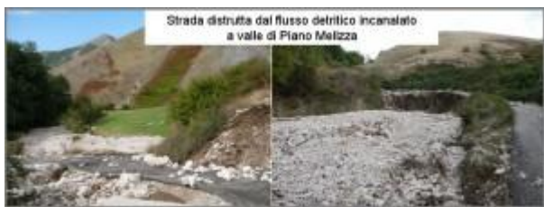
Figura 5: Strada distrutta dal flusso detritico originatosi solo
