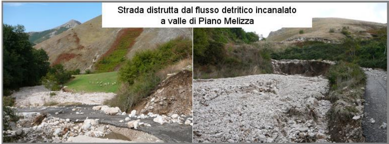
Figura 5: Strada distrutta dal flusso detritico originatosi solo nel vallone che drena la località Melizza.
