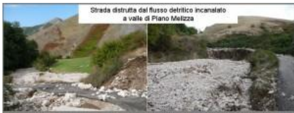
Figura 5: Strada distrutta dal flusso detritico originatosi solo
