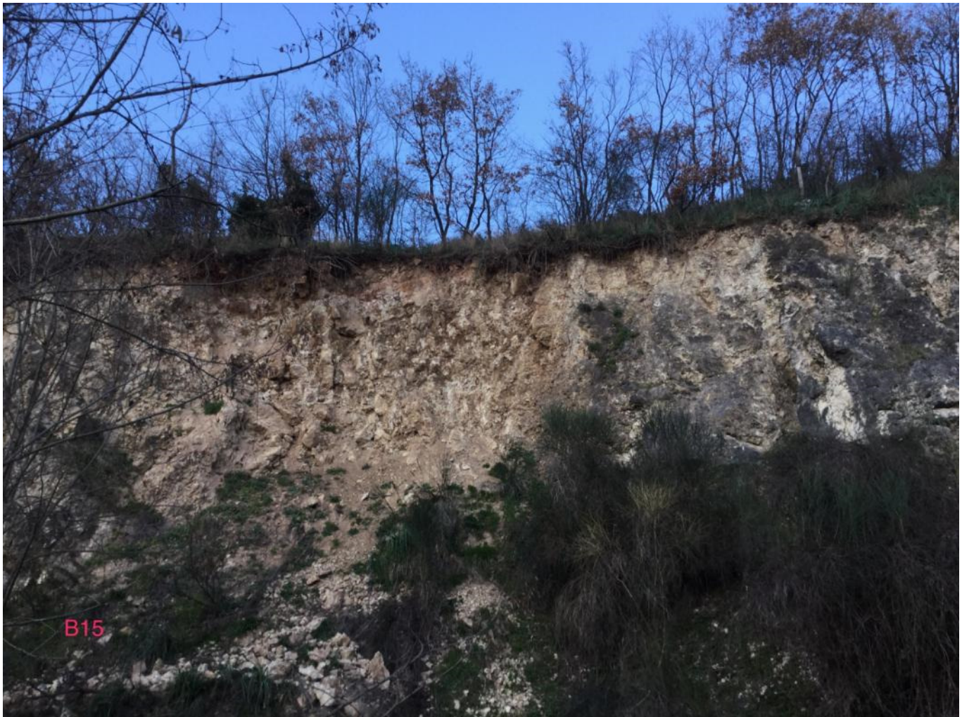
Foto 8 – Fenomeni di crollo s.l. che interessano i termini calcareo-marnosi delle Argille Varicolori Superiori.
