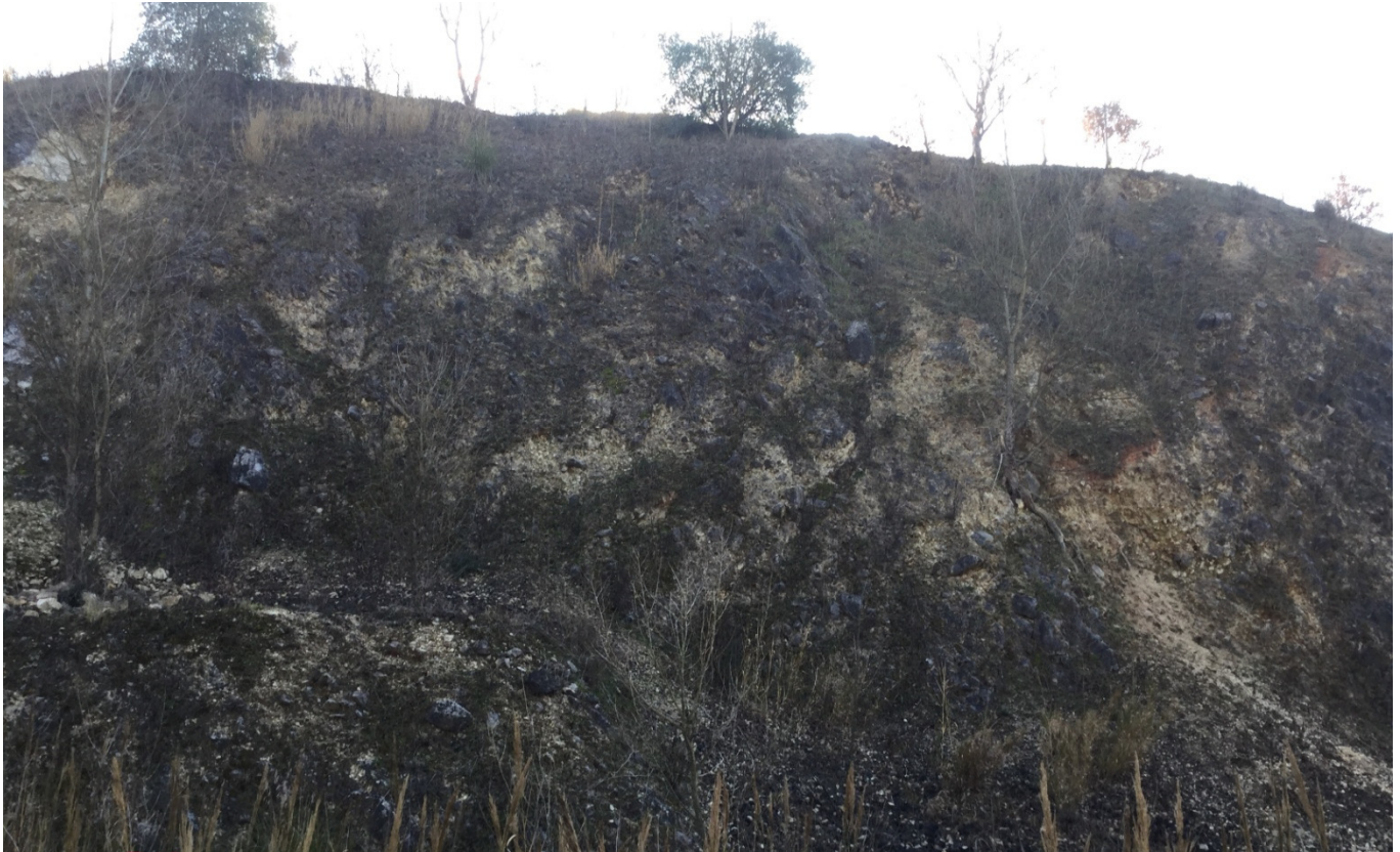
Foto 13- Scarpata soggetta a fenomeni di crollo e/o scivolamenti di piccoli blocchi calcarei appartenenti alla porzione litoide delle Argille Varicolori Superiori (ALVc), dove è riportata la presenza di una "area di attenzione potenzialmente elevata (Aa)".
