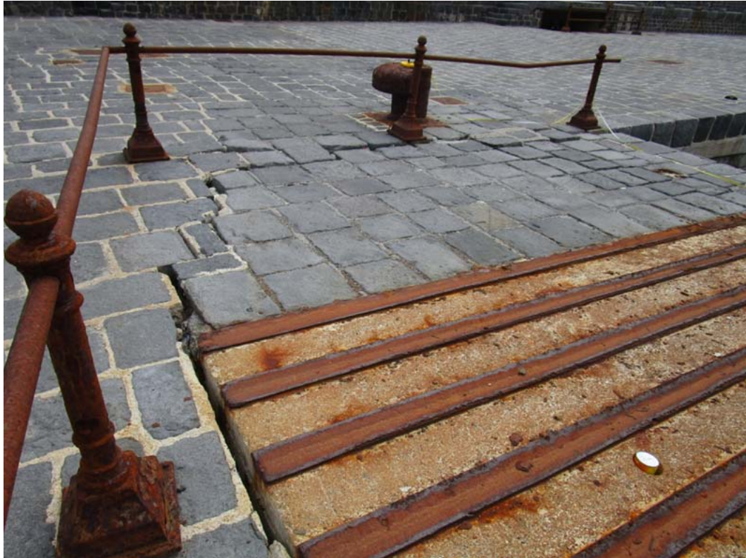
Figura 20 – Elementi di banchina in cattivo stato di conservazione
