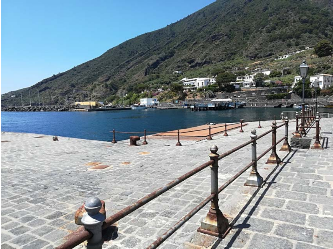
Figura 18 – Ringhiera in acciaio corrosivo
