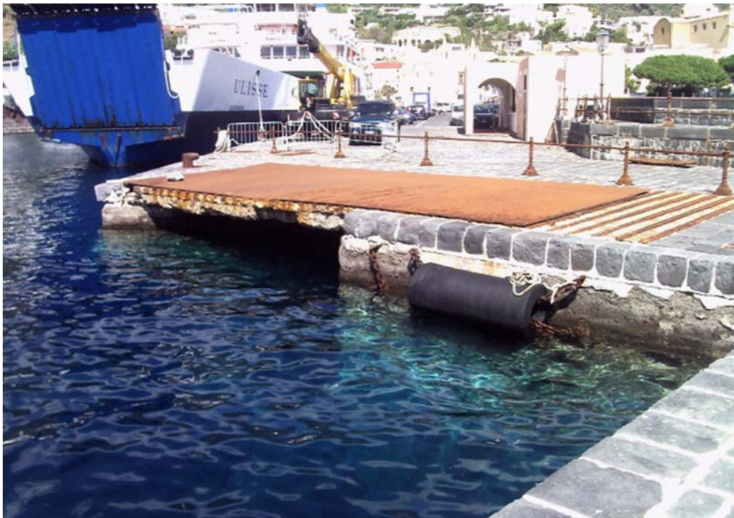
Figura 17 – Scivolo di banchina dissestato e acciaio corroso
