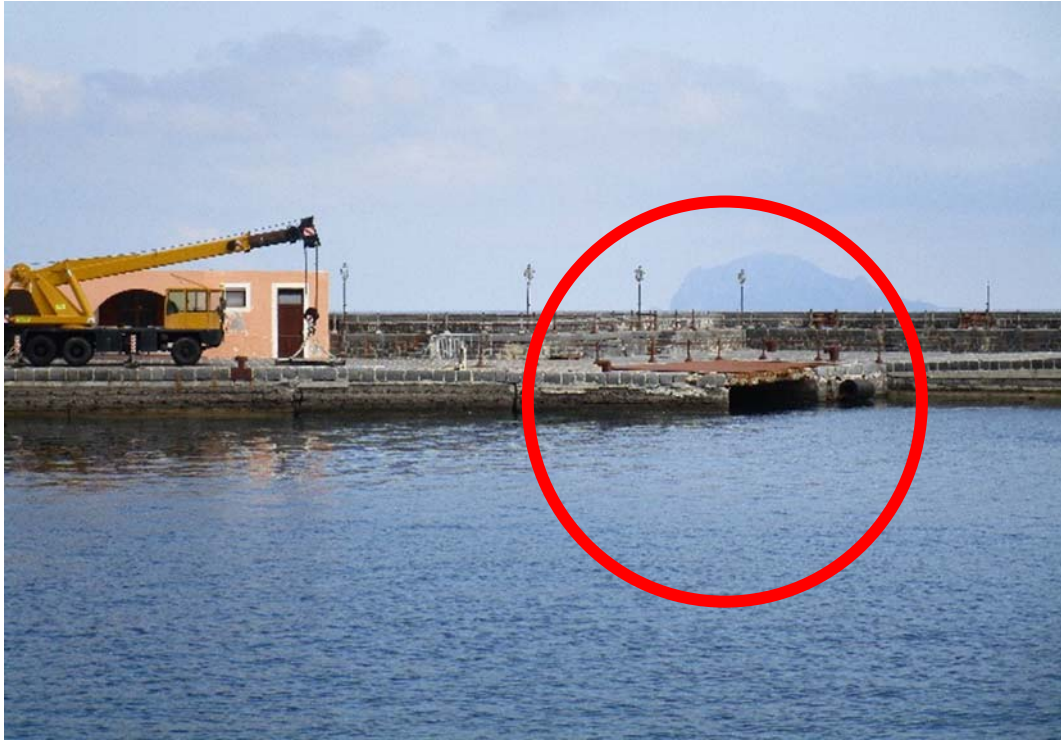
Figura 16 – Profilo della banchina da consolidare con presenza di scavernamento
