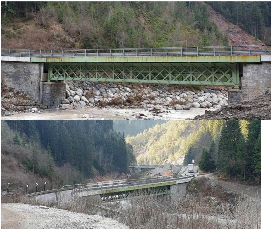
Figura 2: Stato attuale Ponte sul Piave al km 87+000 (Fonte: Lista di controllo)
