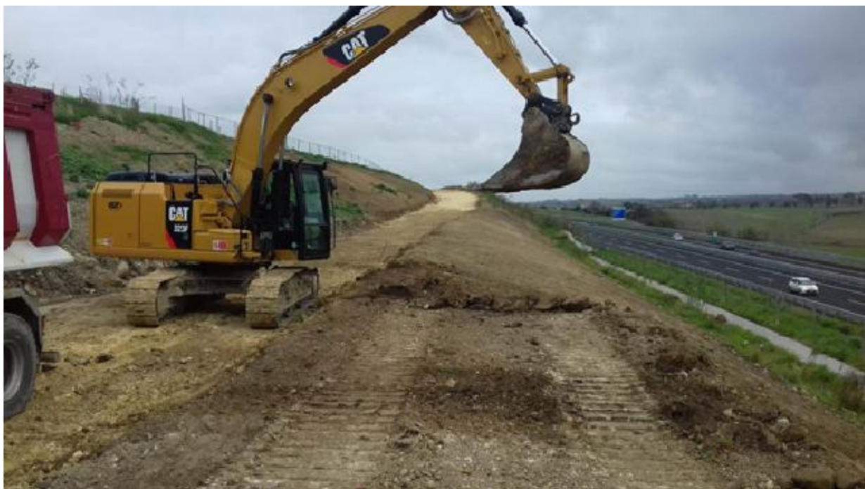
INP 200A Scavo di sbancamento in sx tra la sez. 35 e la sez. 38 circa
