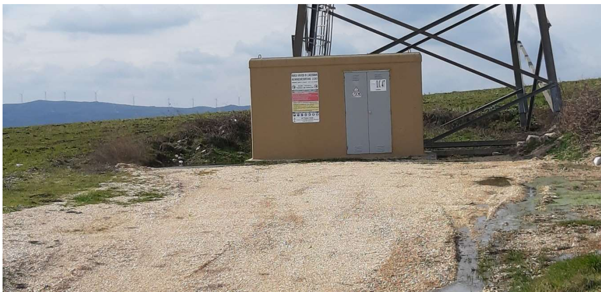
Figura 3: nella foto in alto si vedono parte degli aerogeneratori dell'impianto di Lacedonia-Monteverde in esercizio, mentre nella foto in basso è raffigurata cabina prefabbricata dove è alloggiato il trasformatore e la piazzola tipo attualmente esistente.
