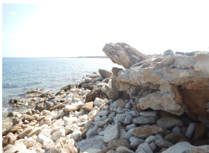
Fig. 3.5: Disgregazione dell'opera foranea a protezione del braccio di sopraflutto. Si osservi anche il ridotto volume dell'opera di protezione e la piccola pezzatura dei massi utilizzati che certamente ne hanno agevolato il processo di disgregazione.
