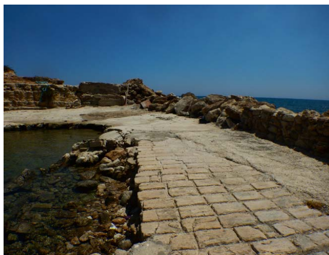
Fig. 3.3: Particolare della banchina esistente sul braccio di sopraflutto. Si osservi sia il cattivo stato del piano di banchina, che l'assenza di un muro paraonde e la disgregazione dell'opera foranea in massi naturali, a protezione del bacino esistente.
