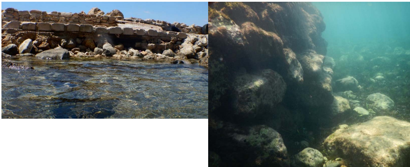
Figura 3.6: Fenomeni di erosione dello stato di imbasamento
