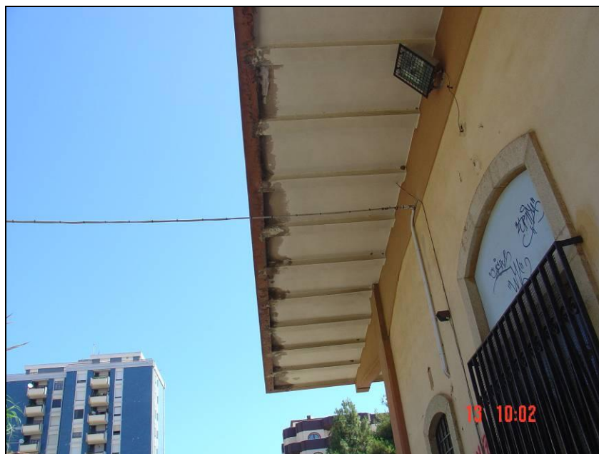
Linea elettrica aerea
