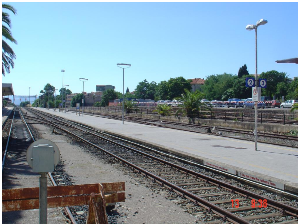
Pali dell'illuminazione del marciapiede ferroviario
