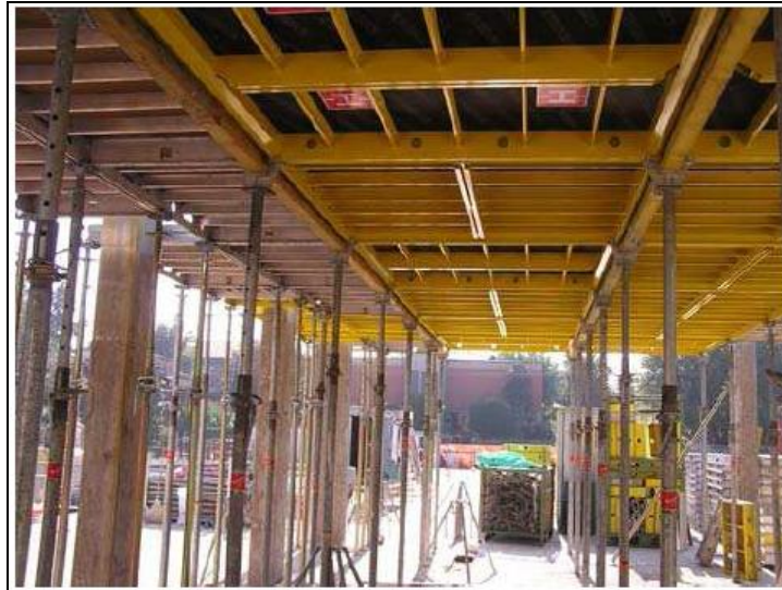
Esempio di solaio gettato in opera con uso di puntelli e casceformi
