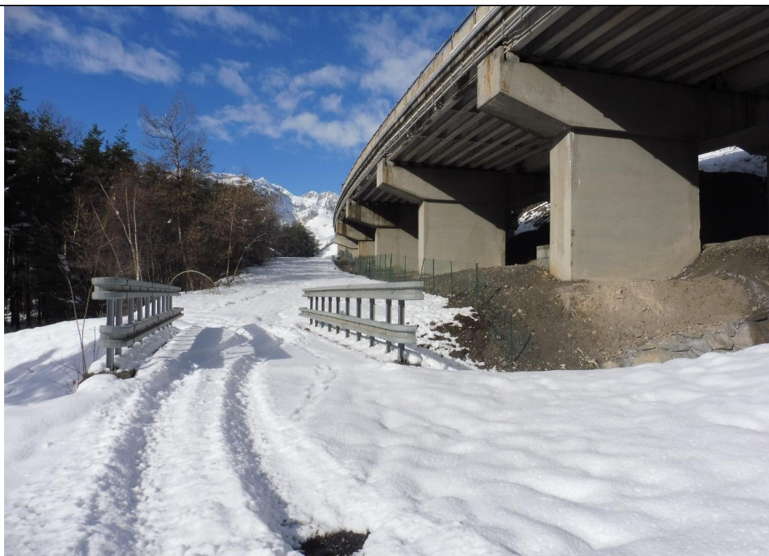
Figura 8 - PUNTO VISUALE P.03 - Vista verso ovest del viadotto esistente e della fascia libera adibita a cantiere
