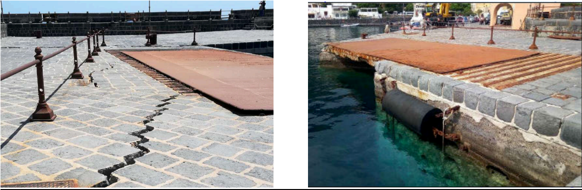
Fig.2 Dettagli dissesto della banchina e fenomeno di svuotamento
