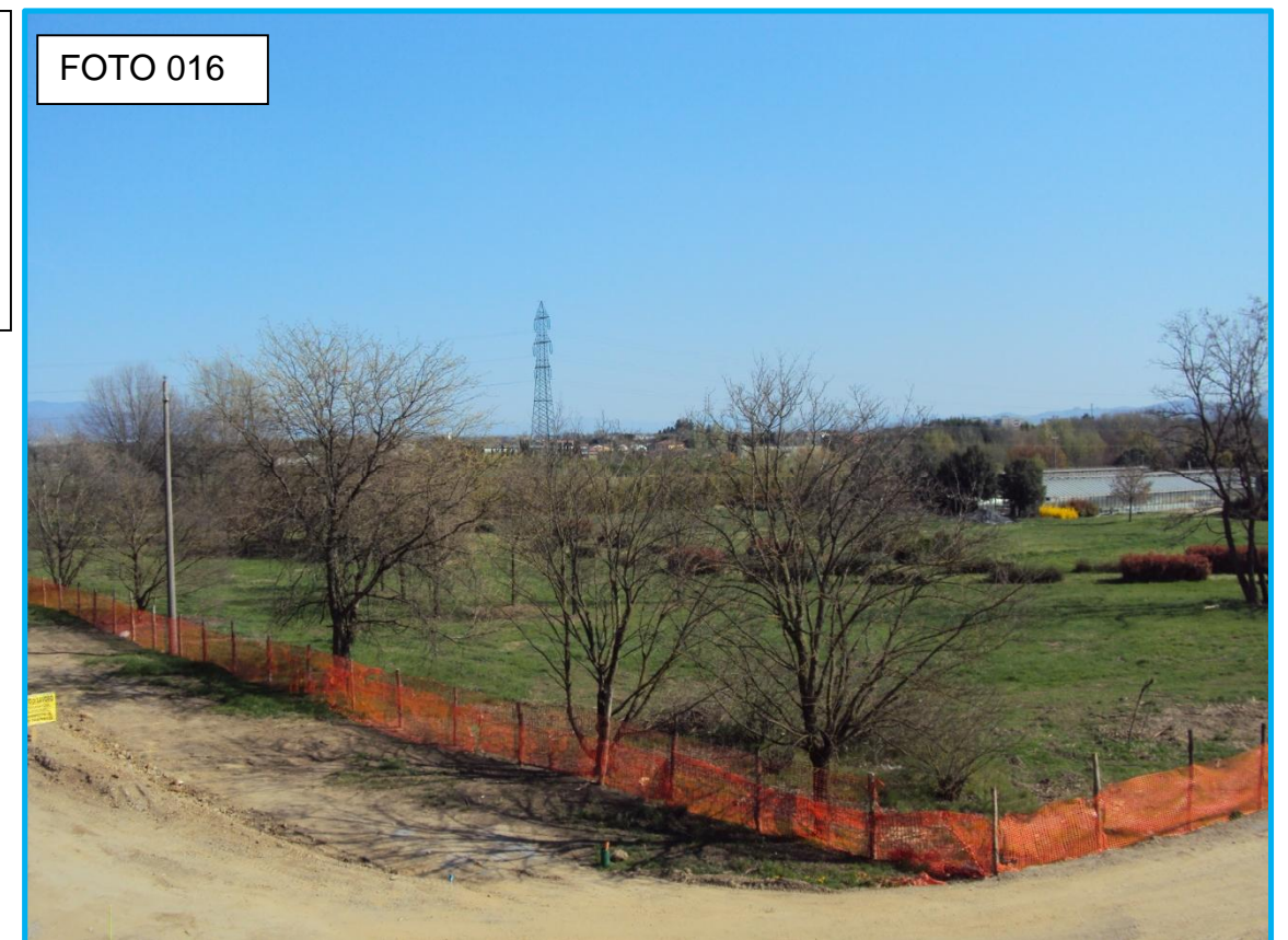
Foto 016 Paesaggio nei pressi dello svincolo di Pistoia. In primo piano opere di cantierizzazione connesse al rifacimento del raccordo di Pistoia.
