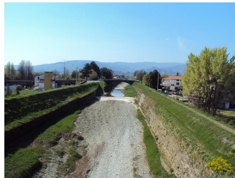
Figura 2-7 Torrente Bisenzio in secca nei pressi dell'abitato di Bonelle Comune di Pistoia.
