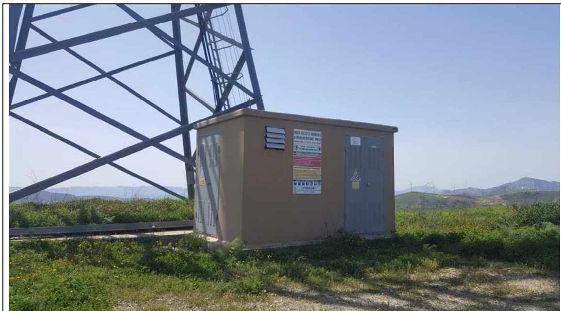
Cabina prefabbricata posta ai piedi di ciascun aerogeneratore – fonte HE
