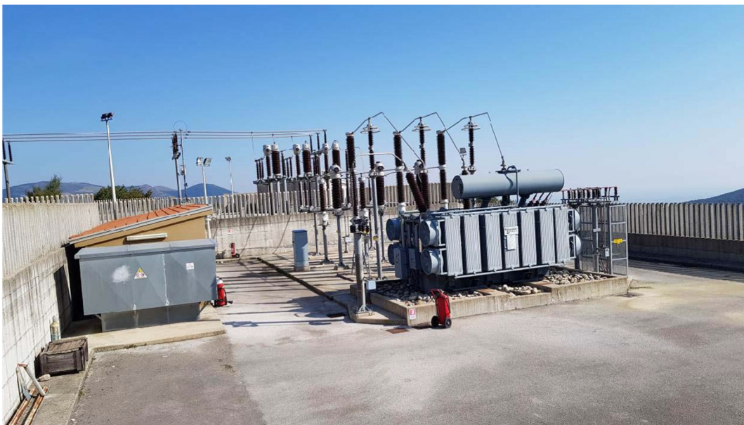
Figura 2 - Inquadramento su ortofoto della Sottostazione di Celle San Vito (FG). In rosso il lato utente (da adeguare), in giallo il lato Terna
