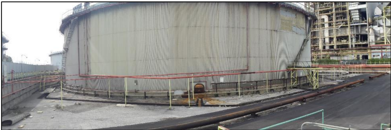
Figura 2.9c Foto da PV2 – Serbatoio da 50.000 m 3 dell'olio combustibile
