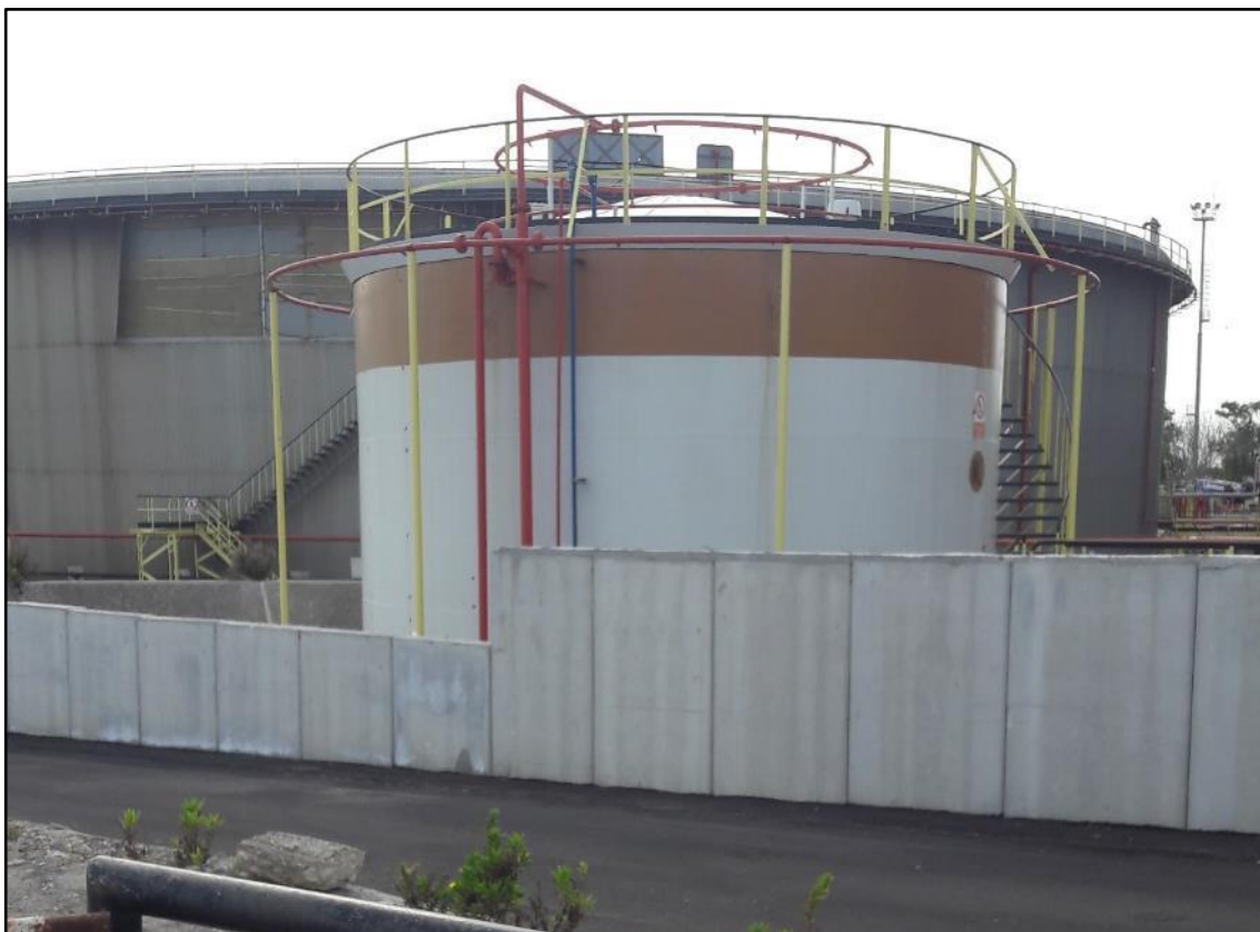
Figura 2.9e Foto da PV4 - Serbatoio gasolio da 240 m 3 e, sullo sfondo, il serbatoio da 50.000 m 3 dell'olio combustibile
