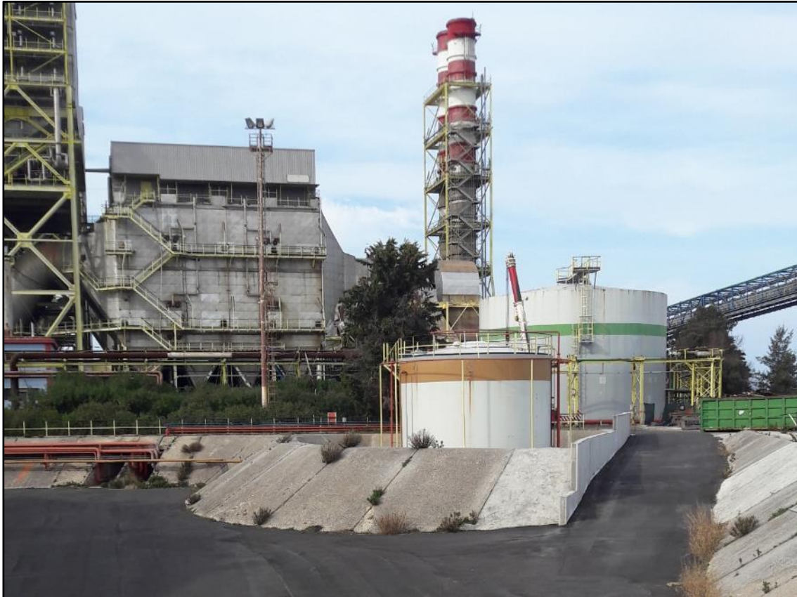
Figura 2.9f Foto da PV5 - Serbatoio gasolio da 240 m 3
