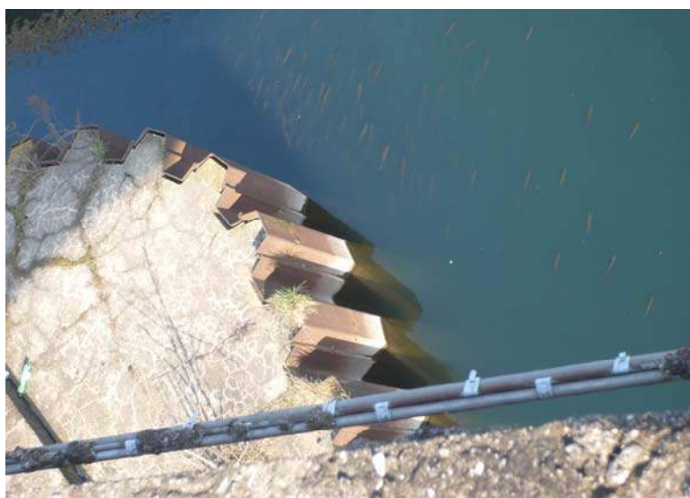
Fig. 2.2.8 – Cintura di palancole e calcestruzzo alla base di una delle pile del ponte storico di Bisnate
