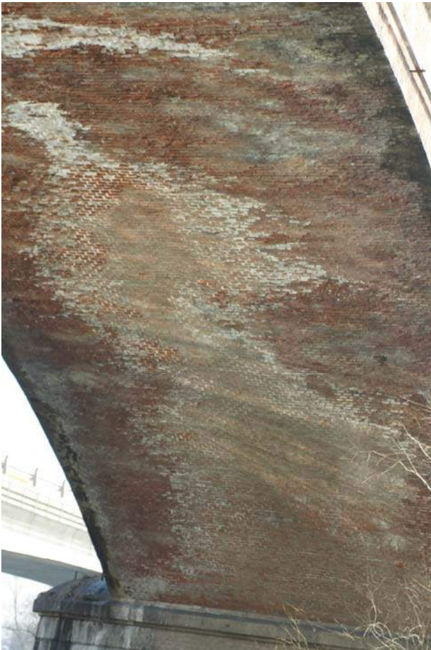
Fig. 2.2.5 – Stato della muratura in corrispondenza dell'arco.
