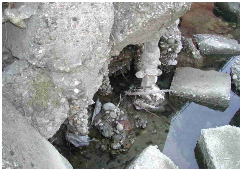
Fig. 2.2.10 – Micropali della cintura a difesa della base delle pile del ponte storico. Si noti l'erosione prodotta dalla corrente
