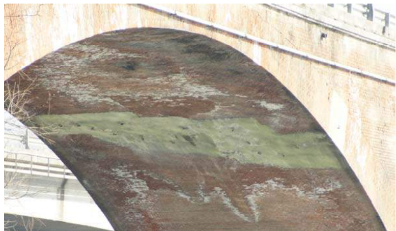
Fig. 2.2.2 – Intervento di ripristino della zona fessurata in seguito al cedimento della pila 3.
