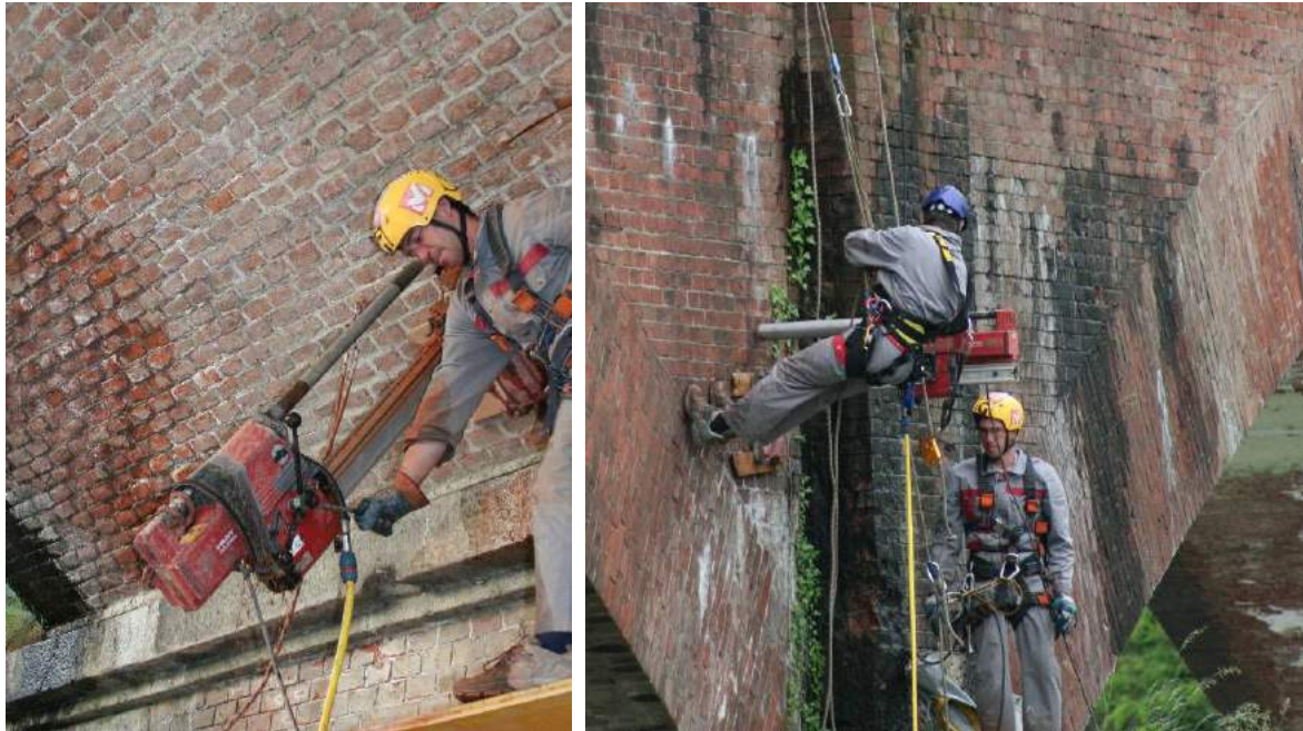
Figura 2. Esecuzione dei carotaggi meccanici sulle murature in elevazione mediante l'assistenza di rocciatori
