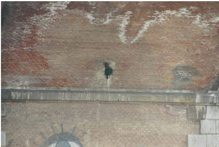
Fig. 2.2.4 – Doccione di scarico delle acque intasato.
