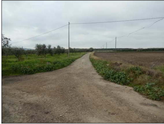
37. Elettrodotto da Strada Vicinale San Pietro verso turbina 6, località Mass. Di Fiore
