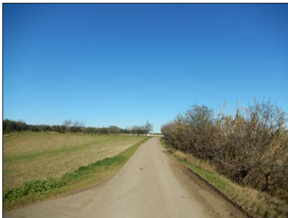
79. Elettrodotta lungo la Strada Vicinale San Pietro da canale Mitrello in direzione della turbina 6, località Capodanno
