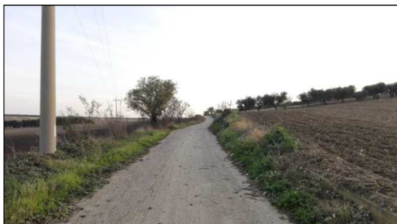
67. Elettrodotto lungo la Strada Vicinale della Scurgola da turbina 7 in direzione di Mass. Culnio
