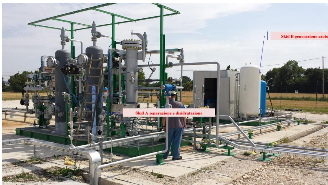
Figura 9 – Esempio di impianto analogo all’impianto di progetto (3/3).
