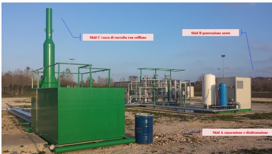
Figura 8 – Esempio di impianto analogo all'impianto di progetto (2/3).
