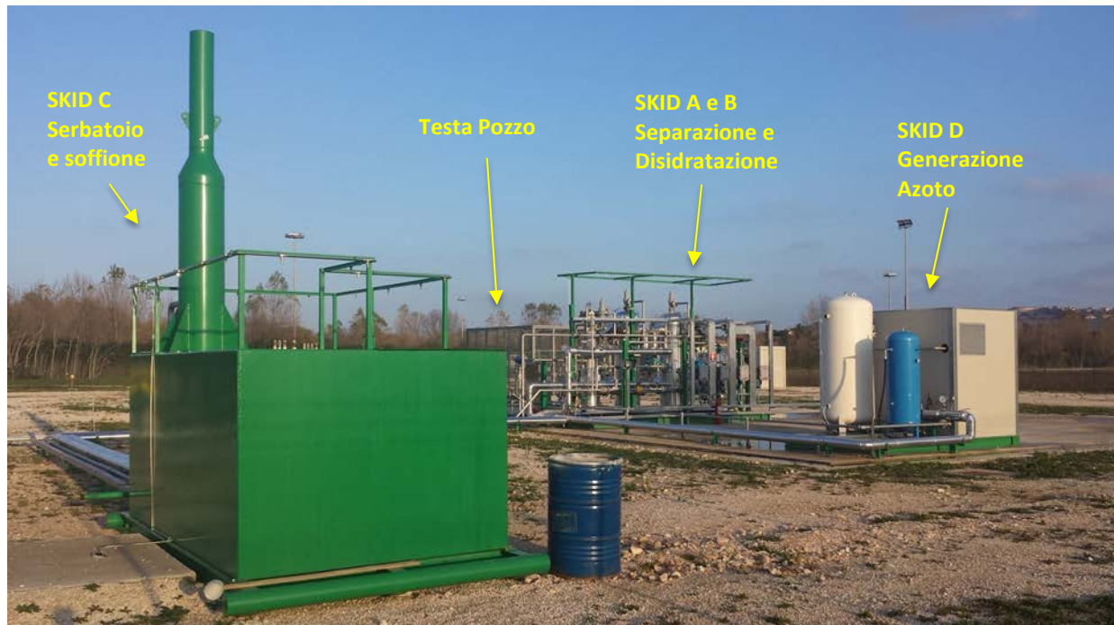
Figura 2-1. Esempio di impianto di produzione e trattamento gas analogo all'impianto in progetto
