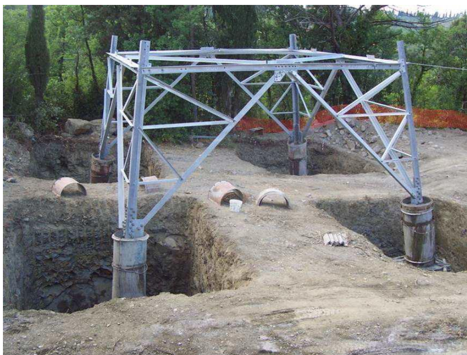
Figura 32: - Esempio di fondazione di fondazioni superficiali tipo CR per un sostegno a traliccio
