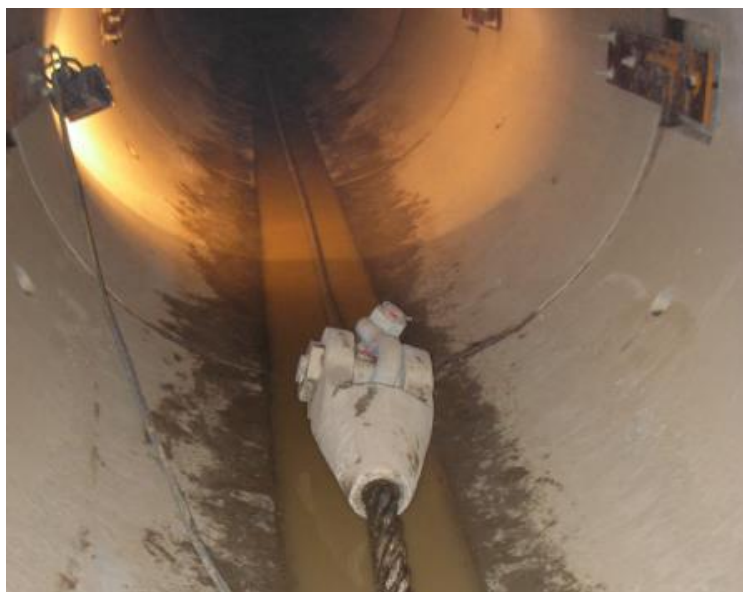
Figura 3.7: Esempio di tiro del cavo messaggero e di quello di tiro all'interno di un microtunnel
