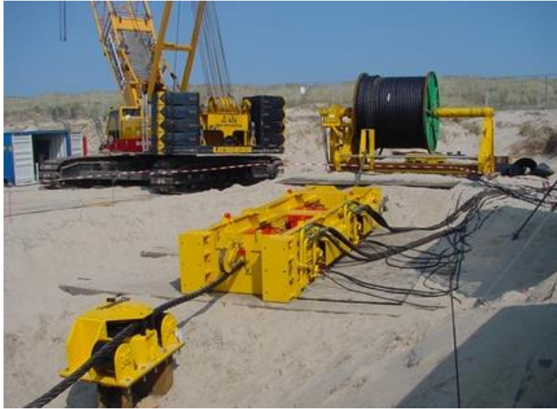
Figura 3.8: Tipologico di verricello installato a terra con cui verrà effettuato il tiro della condotta
