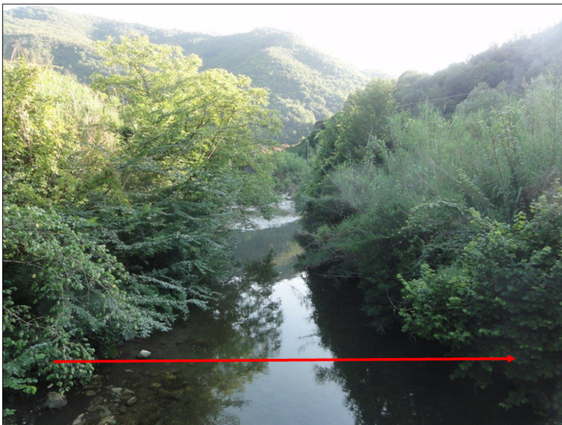
Fig. 3/A: Rappresentazione fotografica dell'alveo del Graveglia nella sezione di attraversamento in progetto
