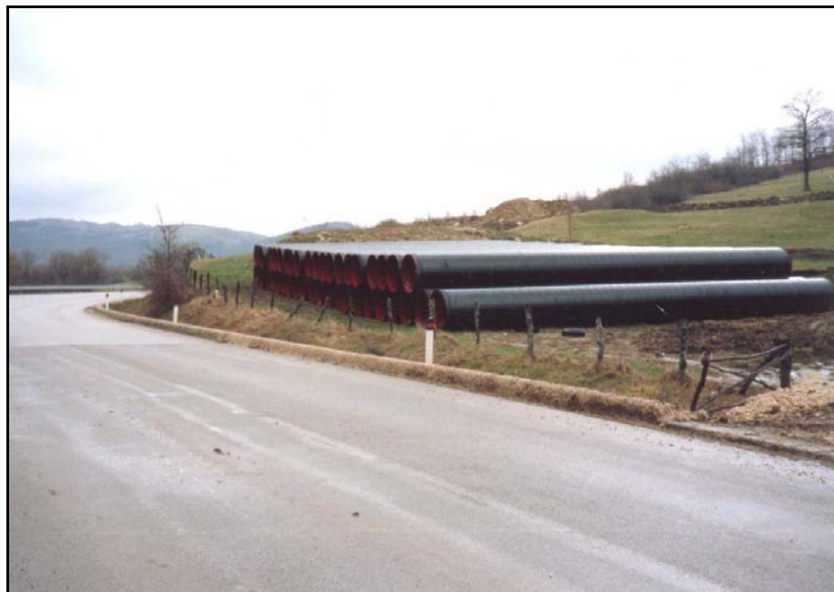
Foto. 2.2/A: piazzola per accatastamento delle tubazioni (esempio relativo ad altro metanodotto con tubi di diametro maggiore rispetto alla linea in progetto)
