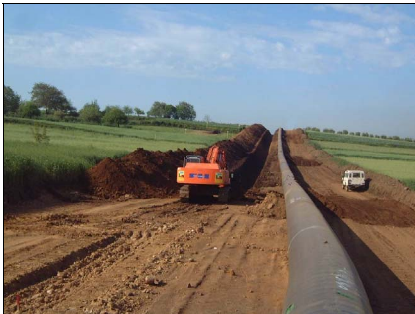
Foto 2.2/C: scavo della trincea con la condotta già sul bordo scavo lungo la pista di lavoro (esempio di condotta con diametro superiore alla linea in progetto)
