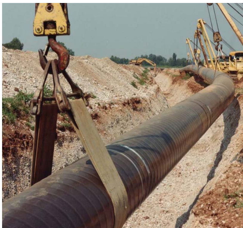
Foto 5/F: Esempio di posa della condotta (esempio di condotta con diametro superiore alla linea in progetto)
