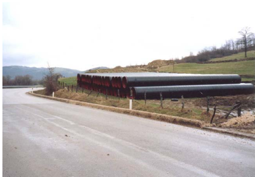
Foto 5/A: Esempio di piazzola accatastamento tubazioni (esempio relativo ad altro metanodotto con tubi di diametro maggiore rispetto alla linea in progetto)
