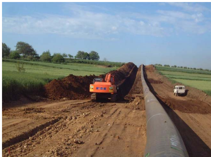
Foto 5/E: Esempio di scavo della trincea (esempio di condotta con diametro superiore alla linea in progetto)
