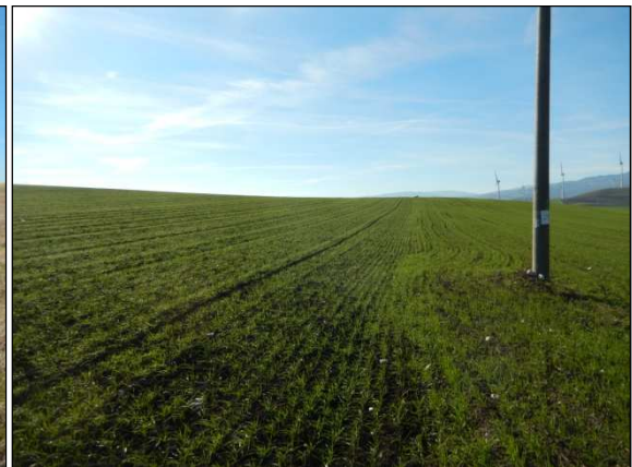
52. Elettrodoto interno in direzione della turbina 4, località Mass. Petitti
