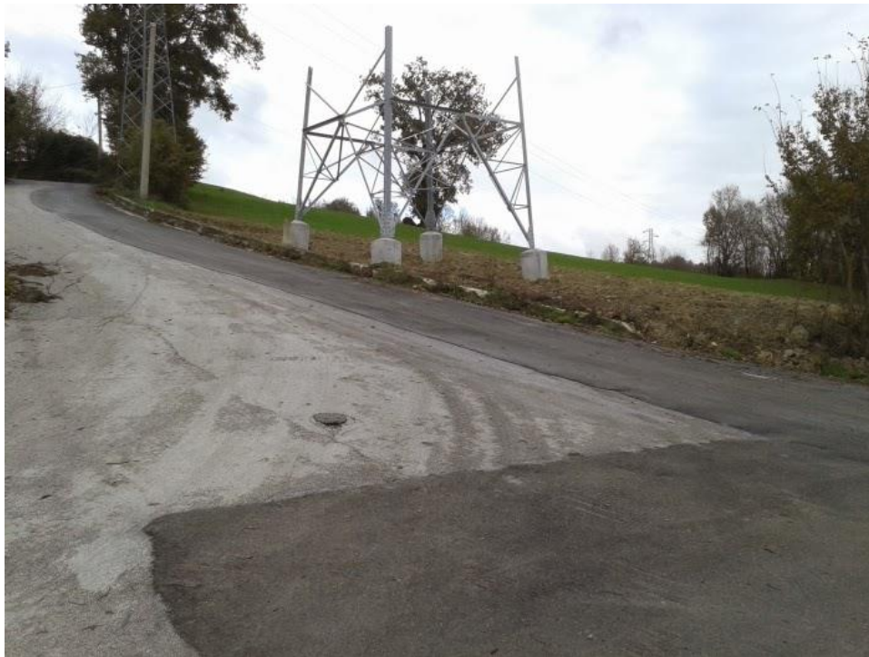
Figura – L'immagine mostra come l'area di occupazione in fase di esercizio, sia solo quella propria del traliccio stesso essendo l'area circostante totalmente ripristinata allo stato precedente.
