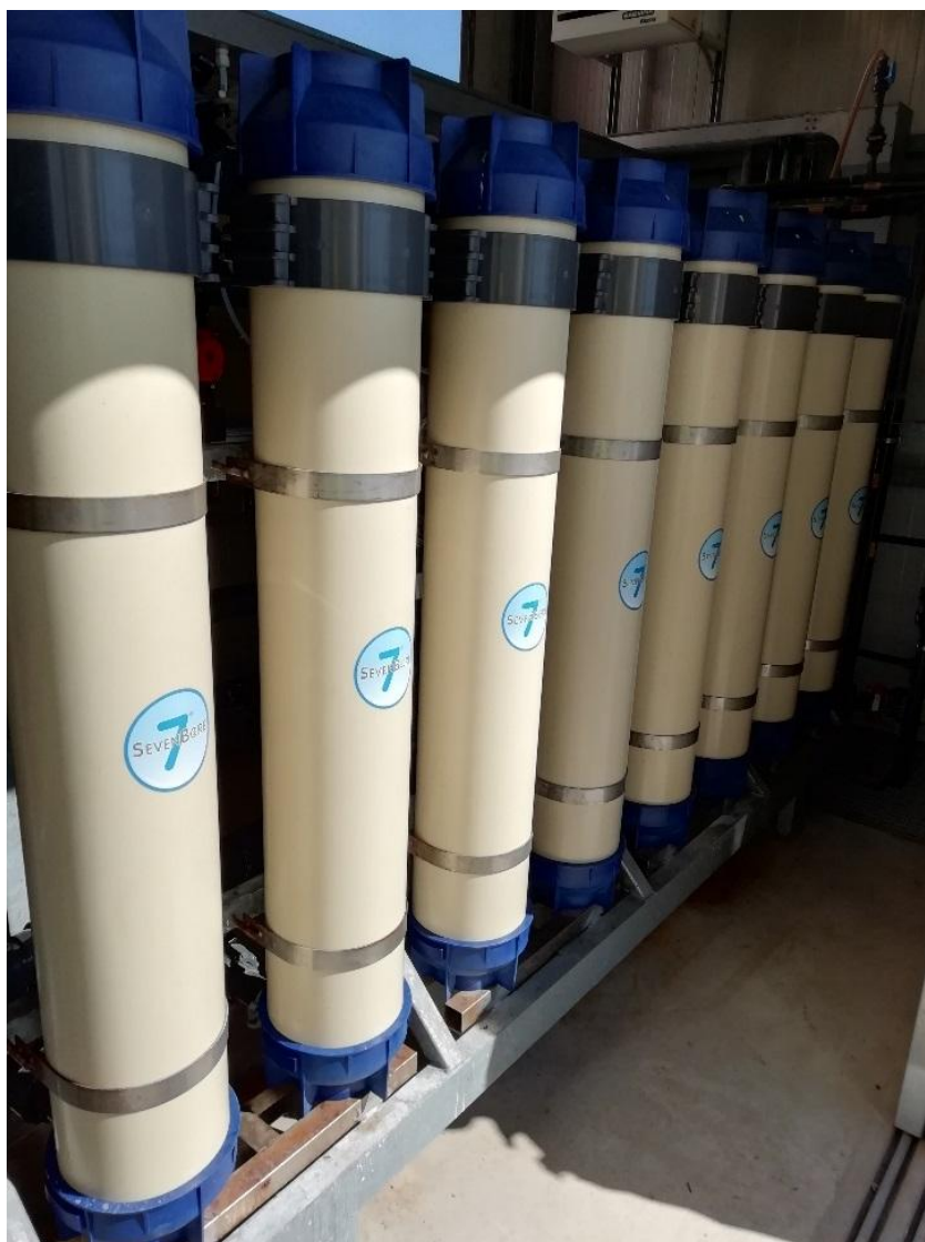
Figura 7 – Dettaglio impianto di ultrafiltrazione
