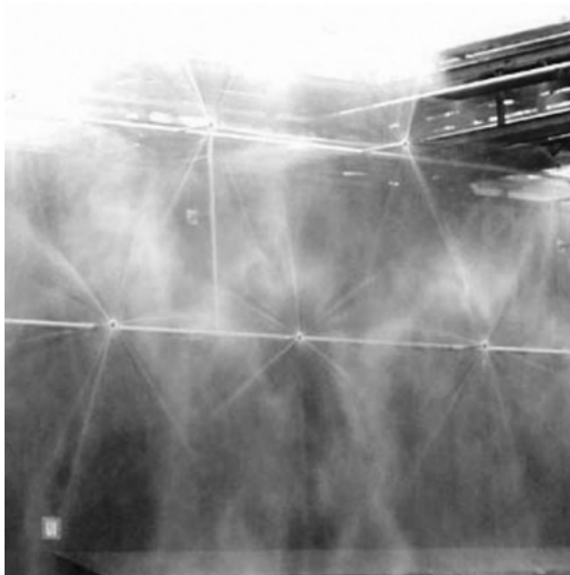
Figura 3.5: Esempio di applicazione di una barriera d'acqua in ambito industriale
