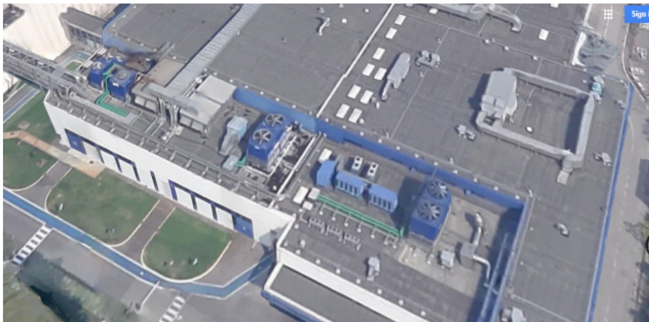
Fig. 2.5.4. – Vista delle torri evaporative della centrale frigorifera principale
