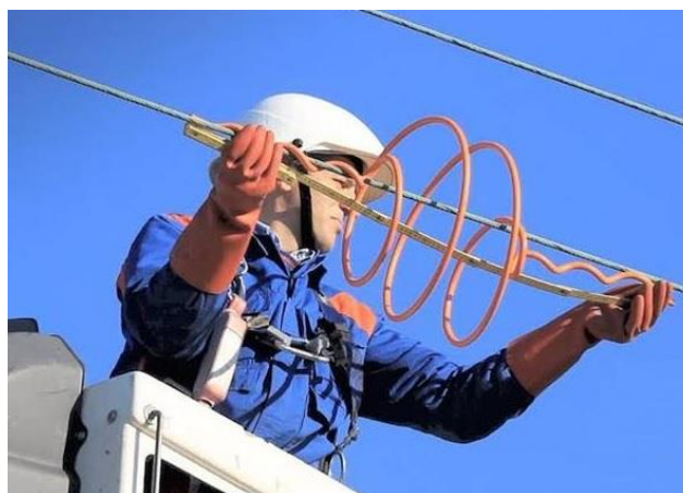
Figura 7.1/1: posizionamento delle spirali di dissuasione
