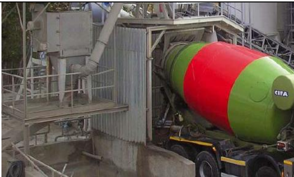
Soluzioni per mitigazione polveri applicate al punto di carico dei prodotti finali
