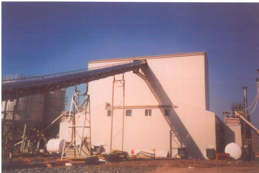
Figura 1.45 Insonorizzazione tramogge inerti
