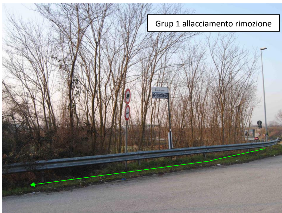
Foto 4.2/B - Porzione di gruppo da abbattere di fianco alla linea oggetto di rimozione (in verde)
