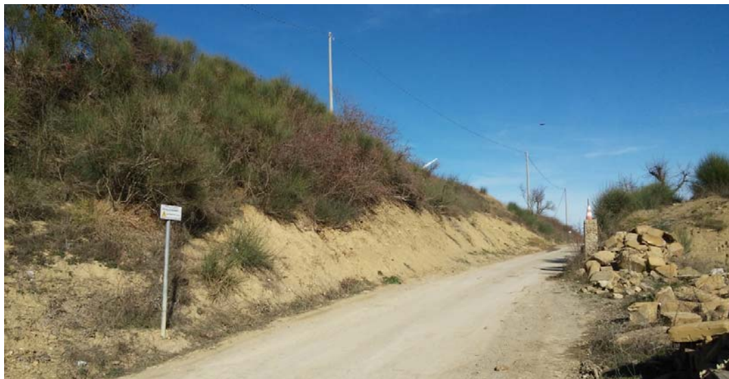
Figura 24 – Scarpata priva di vegetazione, passibile di erosione superficiale.
