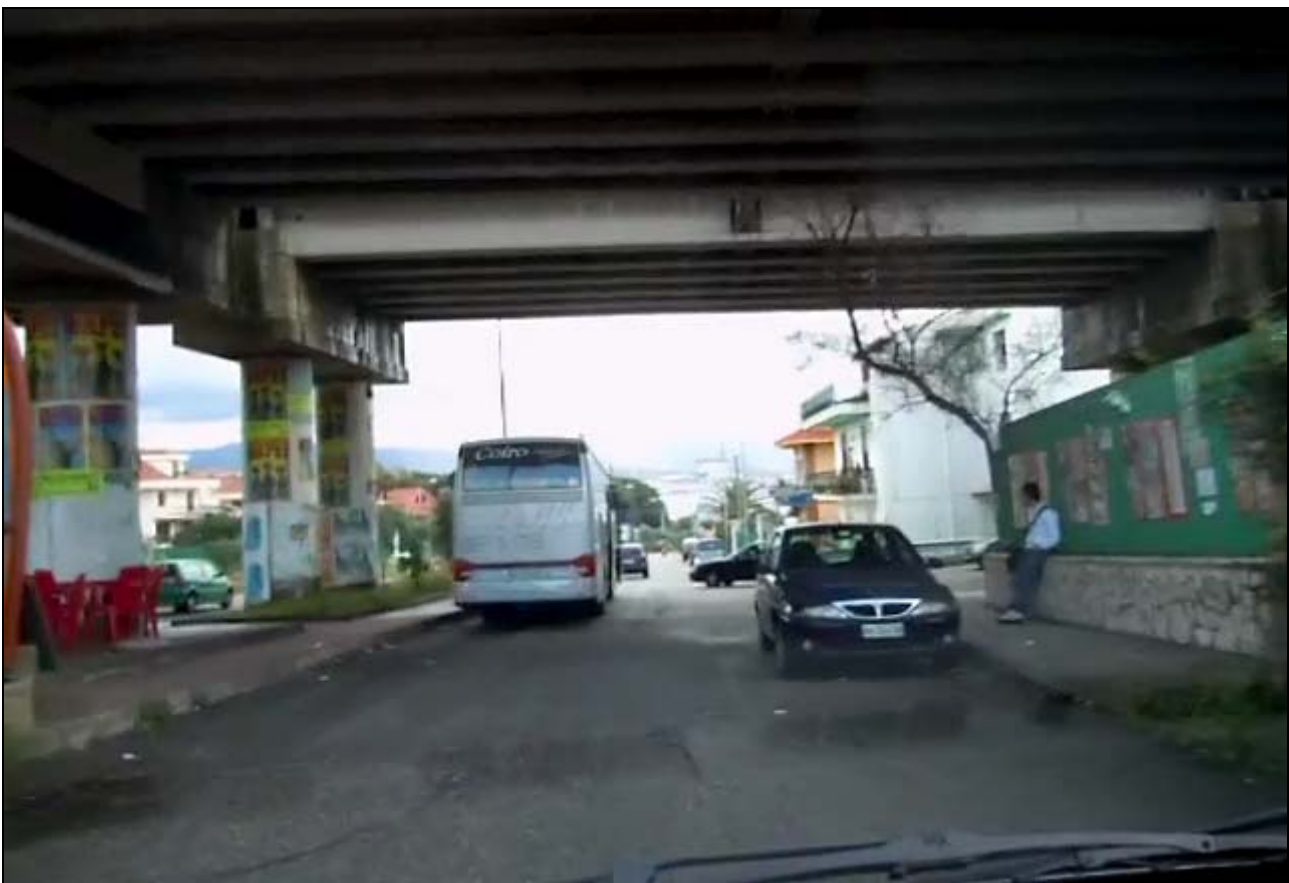
Fotografia 2-36: Controstrada di Via Torrente Sperone (Arco V-SE3.c) per accedere alla Strada Panoramica dello Stretto in direzione Ganzirri. Dei due veicoli presenti, entrambi in sosta vietata, l'autovettura ha anche imboccato la strada contromano. Subito dopo l'autobus inizia il tratto V.SE3.b
