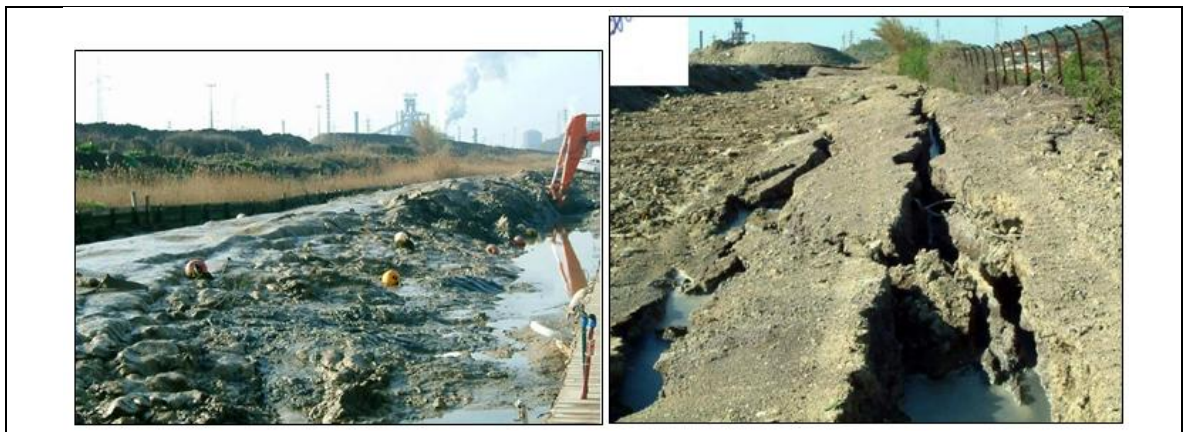
Figura 13-complete otturazione del canale causata dalla traslazione del materiale argilloso a seguito del cedimento della sponda sinistra del Fosso Cornia (sinistra); fratture generate nel livello di riporto industriale prospiciente il fosso all'indomani del dissesto (destra). Le fratture permangono tuttora.
