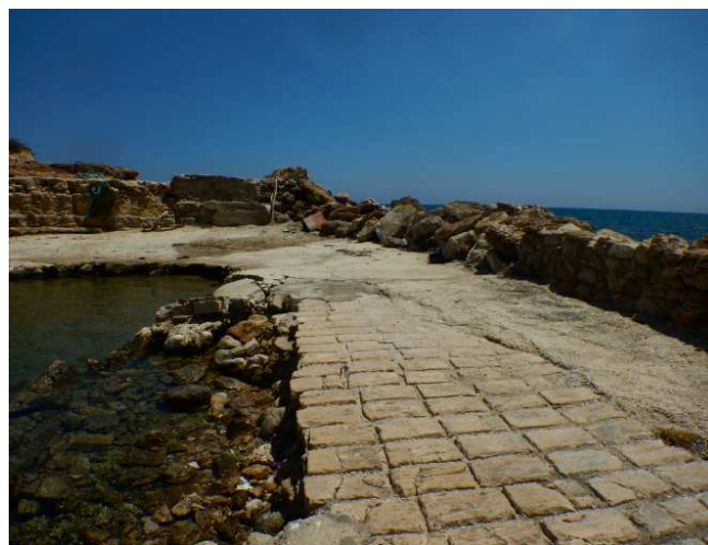
Fig. 3.3: Particolare della banchina esistente sul braccio di sopraflutto. Si osservi sia il cattivo stato del piano di banchina, che l'assenza di un muro paraonde e la disgregazione dell'opera foranea in massi naturali, a protezione del bacino esistente.
