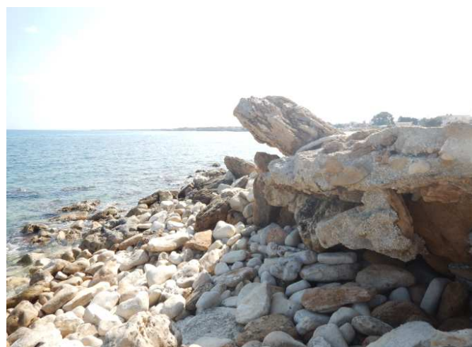
Fig. 3.5: Disgregazione dell'opera foranea a protezione del braccio di sopraflutto. Si osservi anche il ridotto volume dell'opera di protezione e la piccola pezzatura dei massi utilizzati che certamente ne hanno agevolato il processo di disgregazione.
