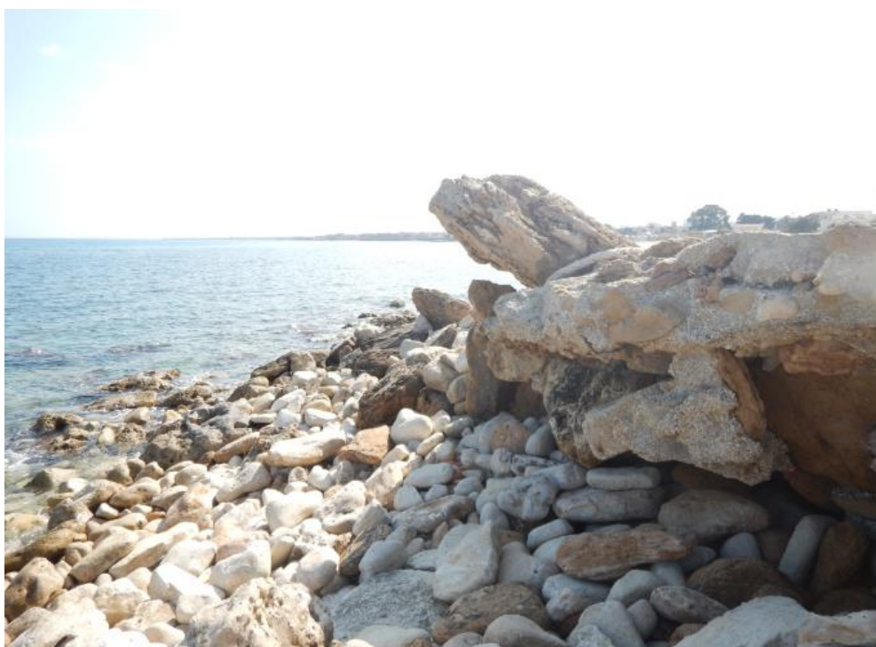
Fig.1E- Disgregazione dell'opera foranea a protezione del braccio di sopraflutto
