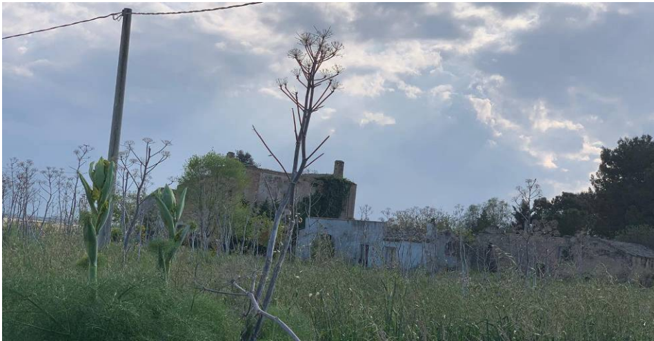
Foto P3: Masseria Salice presente a nord-ovest dell'area d'impianto. (Segnalata nel PPTR) Si presenta un complesso di immobili in stato di degrado e non regolarmente abitati
