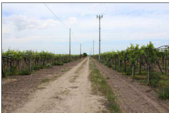
38. Elettrodotto tra le turbine 12 e 10, località Cannone
