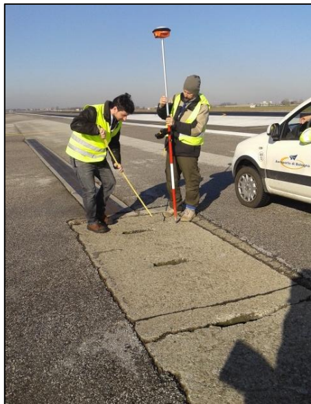
3 - Rilievo della profondità delle griglie superficiali in prossimità della bretella di uscita rapida.
