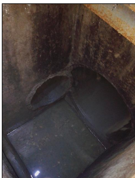
1 – Confluenza tra un collettore principale lungo la linea centrale di 100 cm e un collettore secondario di 60 cm.
