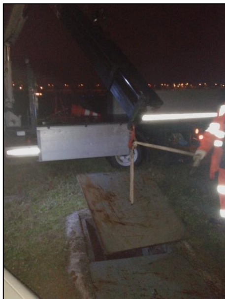
7 – Apertura della botola al di sopra del collettore principale verso lo scarico B.
