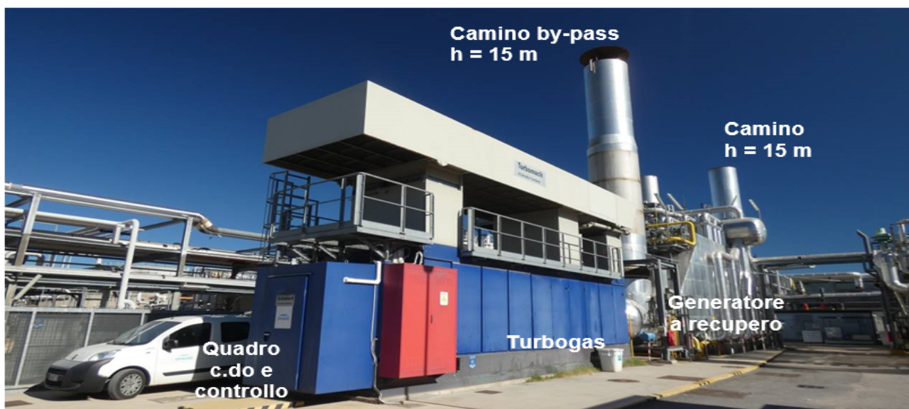
Figura 6 Turbogas TG1 attualmente in esercizio nella Centrale ENGIE Servizi S.p.A.
