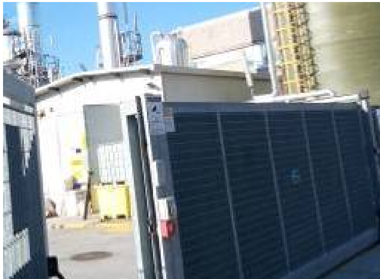
Figura 4.6/15 Locale contenente impianto di trattamento acqua, con caratteristiche analoghe a quello in progetto
