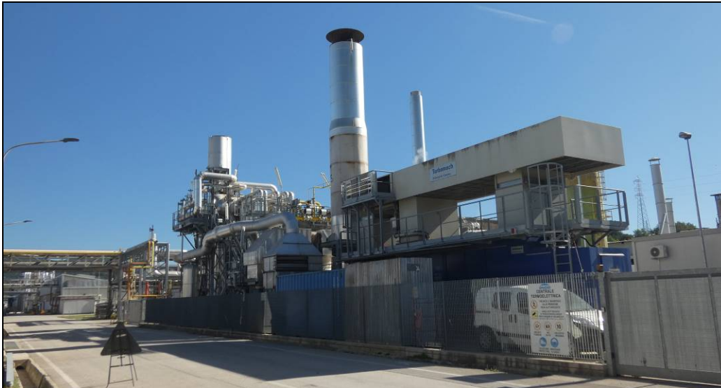
Figura 5 Stabilimento Alcantara - Impianto già in esercizio presso la Centrale Engie ed analogo a quello di prevista realizzazione
