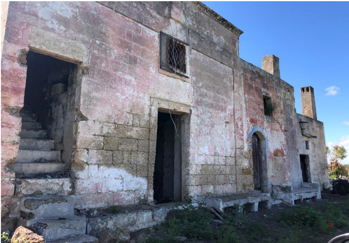
PUNTO SENSIBILE 18 FABBRICATO PERICOLANTE
