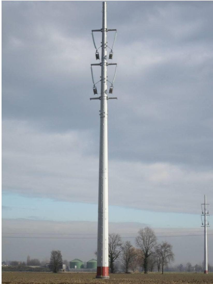
Figura 19 - Sostegno monostelo montato. Si notino le carrucole collegate alle catene degli isolatori, fase che precede la “tesatura” dei conduttori
