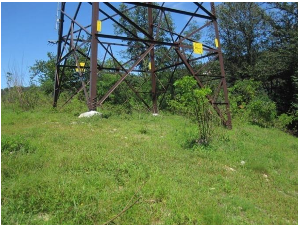
Figura 66 - Interventi di rinaturazione ante e post operam sulle linee 132 kV della Val D'Ossola Sud
