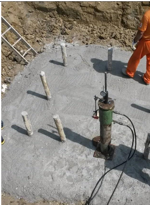
Figura 27 - Realizzazione di micropali tipo tubfix per un sostegno a traliccio; si possono osservare i 9 micropali già realizzati ed iniettati; in questa fase, prima dell'armatura e cassetatura del plinto di fondazione, si sta eseguendo una prova di tenuta del micropalo allo strappamento, al fine di verificare la corretta progettazione e realizzazione dello stesso
