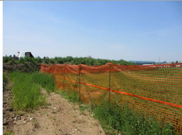
Vista delle reti di delimitazione della duna e del fronte nord della stessa, sullo sfondo a destra le barriere fonoassorbenti attualmente installate sulla A4
