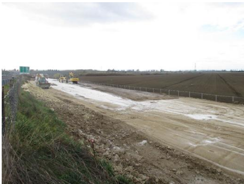
INP 200B Formazione rilevato. Trattamento a calce sez. 16 sez. 26 circa, sesto strato
