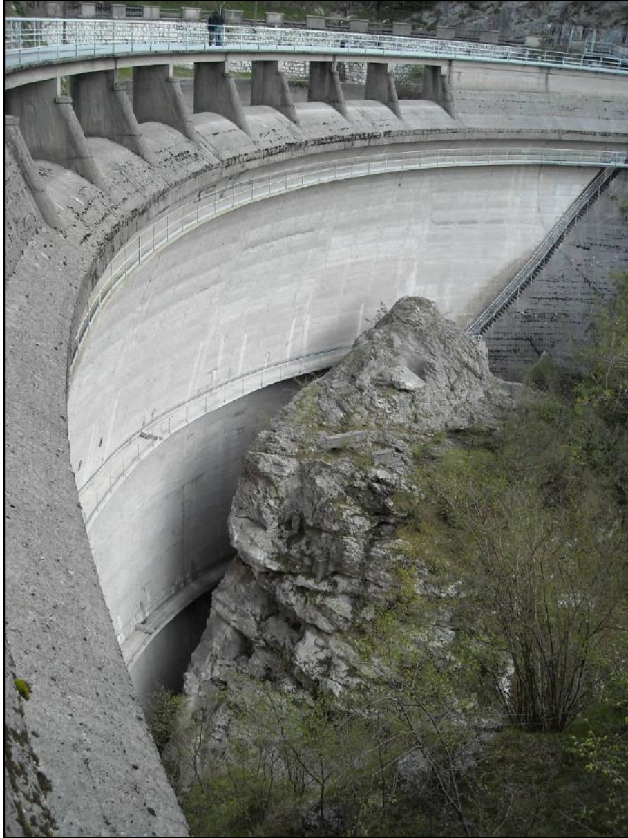
Figura 6.1c Vista dello scarico di superficie in corpo diga a ciglio sfiorante
